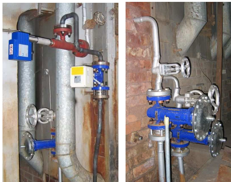
Rys. 15 Modernizacja i automatyzacja systemu odsalania i odmulania na kotle OR 16. a/ pomiar przewodności, zawór odsalający i zawór odmulający komory przedniej b/ zawory odmulające komór tylnej i bocznej lewej
