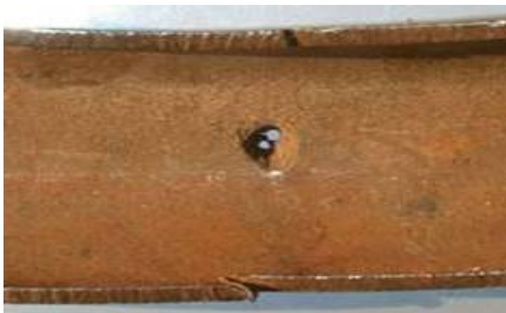
Rysunek 2. Uszkodzenie rurociągu kondensatu na skutek oddziaływania korozji tlenowej.
