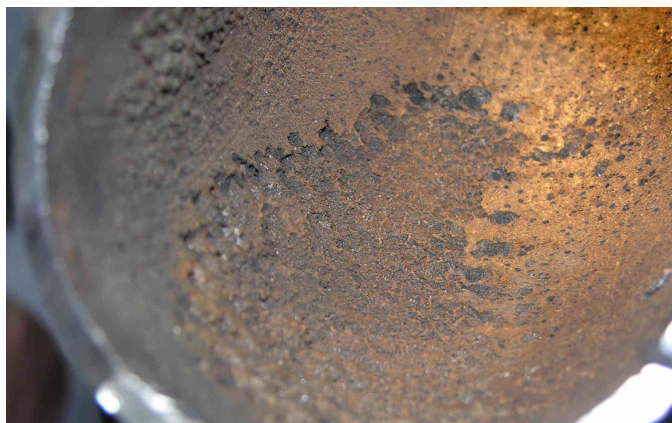
Rysunek 7. Korozja kawitacyjna kolana rurociągu kondensatu.
