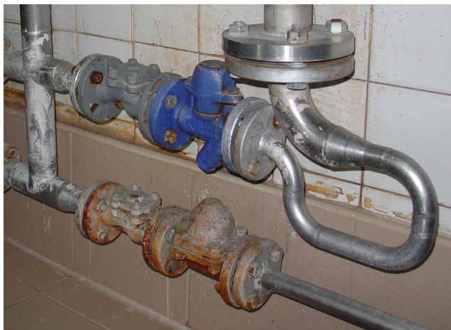
Rysunek 10. Armatura ze stali węglowej zabudowana na instalacji kondensatu wykonanej ze stali kwasoodpornej
