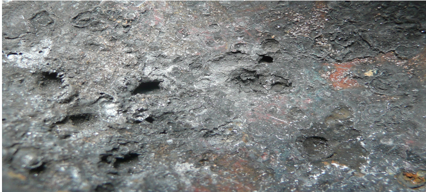
Rysunek 6. Korozja wżerowa zachodząca pod osadami (po usunięciu osadów)
