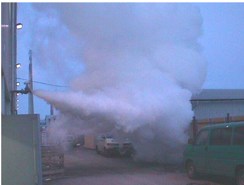
Rys.1 "Parujące" pieniądze – para przebija się przez niesprawne odwadniacze do instalacji kondensatu, a następnie wypływając przez wydmuch ze zbiornika kondensatu jest tracona
